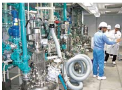
治験原薬製造棟内の化学合成反応作業室
