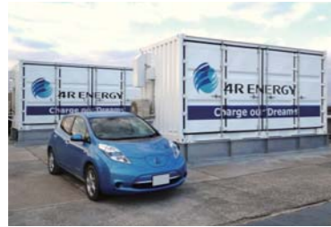
世界初の大型EVリユース蓄電池システム
