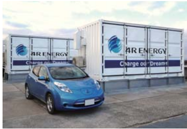
世界初の大型EVリユース蓄電池システム
