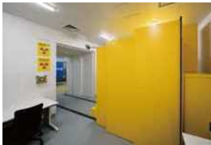
2mの厚さのサイクロトロン室の遮断扉
